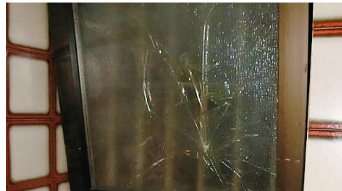
I danni provocati nel bagno del bar Centrale (foto prinz)
